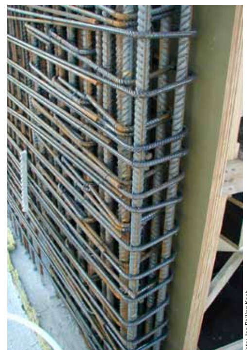
Bewehrungsdichte vs. Verdichtung
